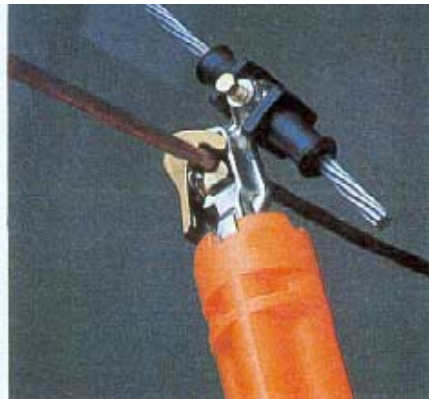
Colocação do ligador na linha principal (o peso da vara de gancho é suficiente para fechar o bico móvel).
